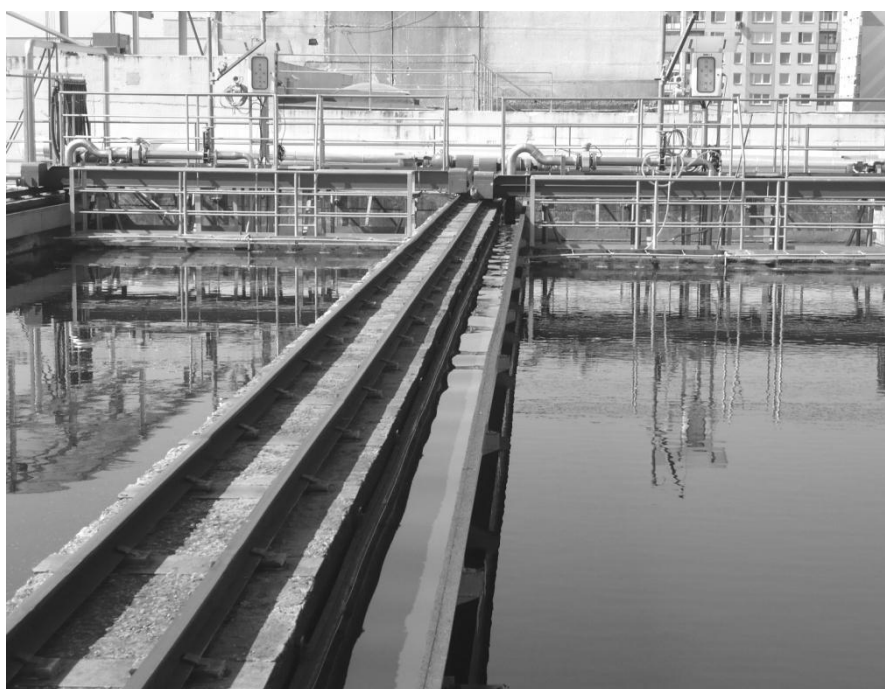
Obr. 8: Dosazovací nádrže ČOV Lutín
