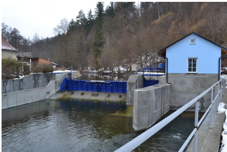
Obr. 24 Jez s malou vodní elektrárnou vybudovaný v obci Hoštejně (pořízeno 21.3.2013)
